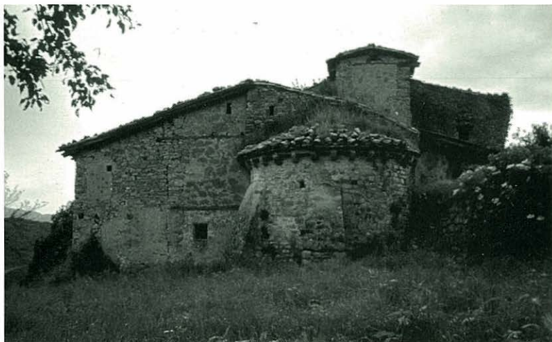
L'església de Sant Andreu de Porreres va quedar també afectada pels moviments sísmics del segle XV. Actualment és un dels edificis romànics més malmesos del municipi bianyenc.
